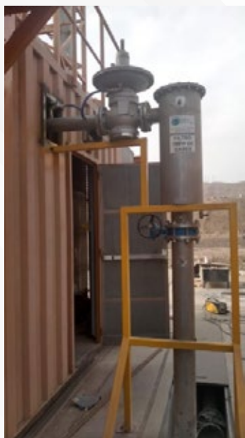
TUBERÍA ENCHAQUETADA ARCOR
