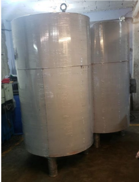
TANQUES DE ALMACENAMIENTO DE GLICOL PETRAMAS - HUAYCOLORO
